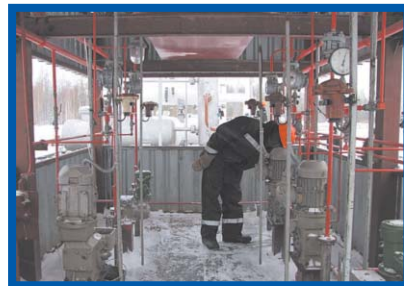
Блок подачи метанола. Установка подготовки газа на Ярактинском нефтегазоконденсатном месторождении
