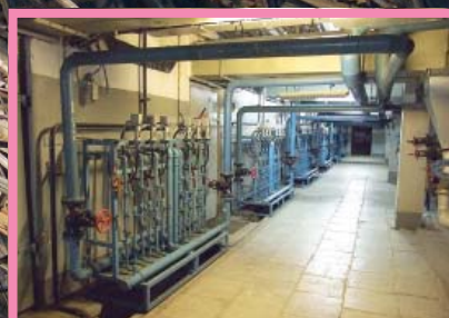
Часть системы охлаждения передатчиков
